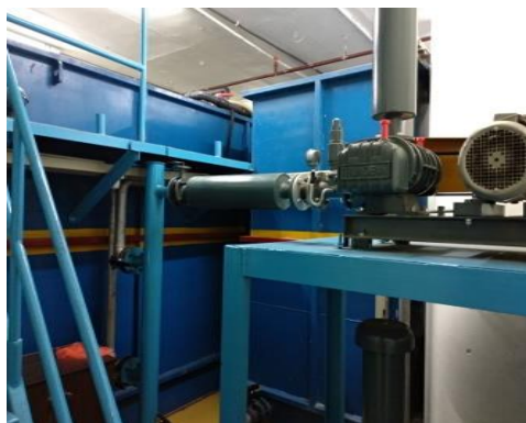
STP, Saiham Tower
